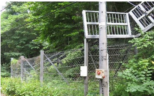
現地の落石検知装置
