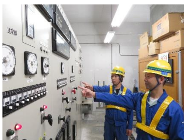
変電設備の点検
