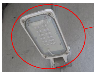
(非常電灯電源設備)
