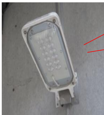
非常電灯（拡大）
