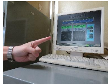
風速計・雨量計の確認
