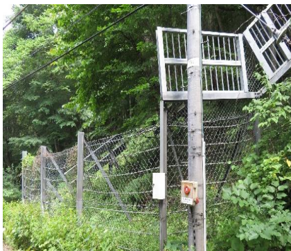
現地の落石検知装置
