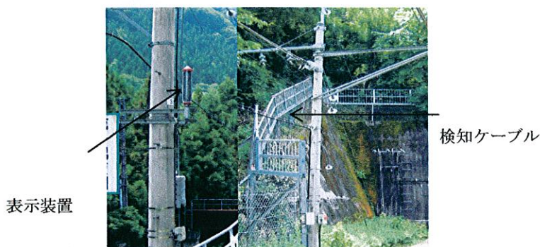
(現地落石検知装置)
