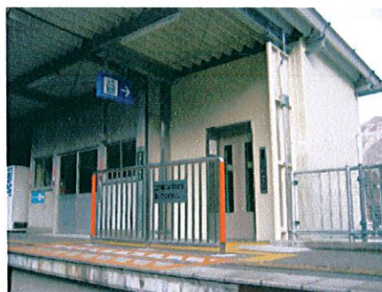
(ホーム下転落防止柵)
