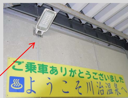
非常電灯電源設備
