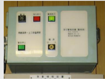
落石検知表示装置
