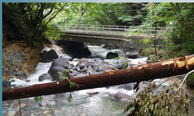
龍王峡駅構内 橋梁基礎の洗掘
