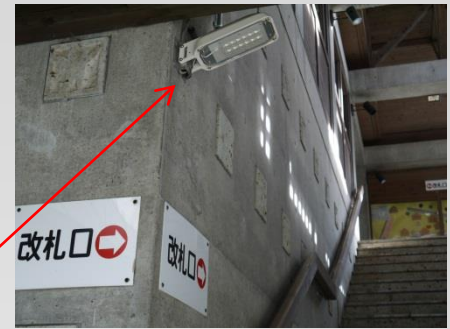
非常電灯電源設備
