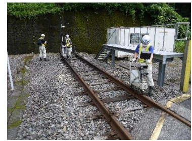
手押し式の超音波探傷検査
