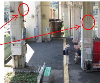
非常電灯電源設備
