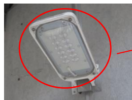
(非常電灯電源設備)
