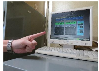
風速・雨量計の確認
